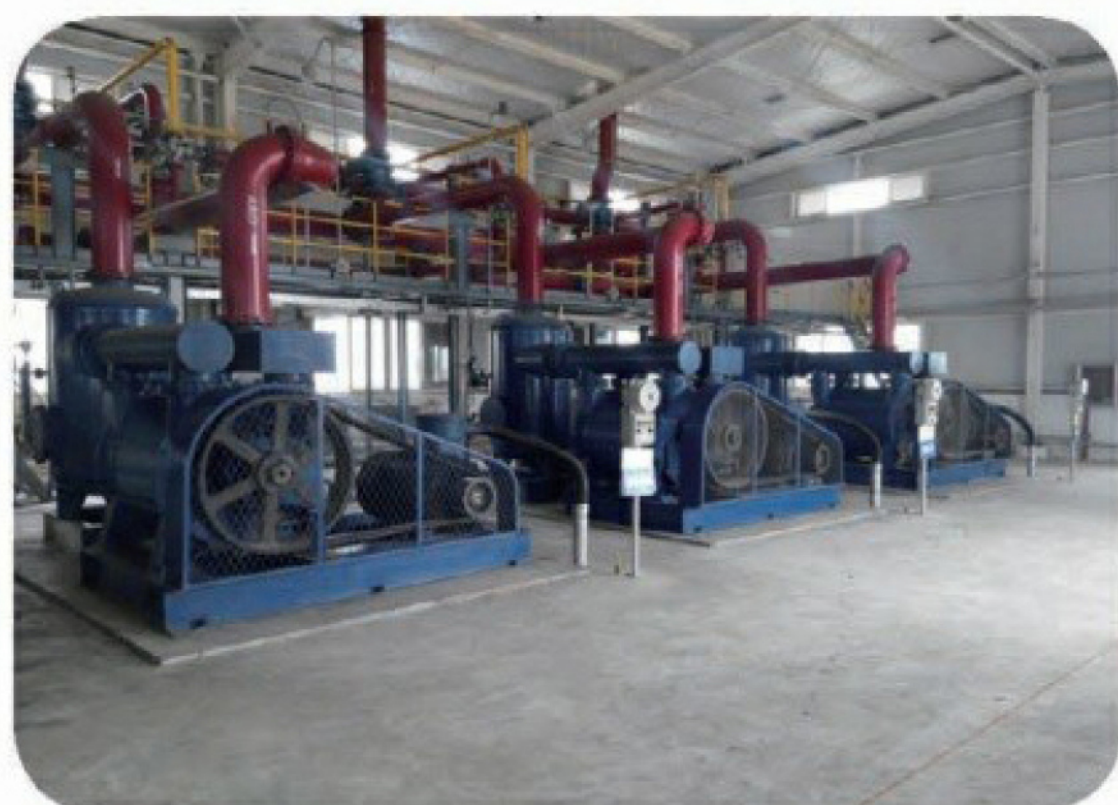
煤矿瓦斯抽放 Coal mine gas
