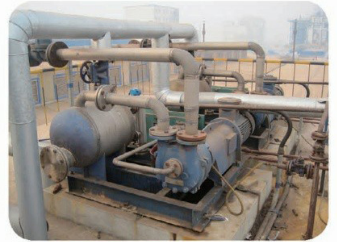
钛材氯气输送
